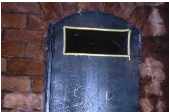
Accès adapté aux chauves-souris dans la porte de la cave du Château de Trévarez (29)
